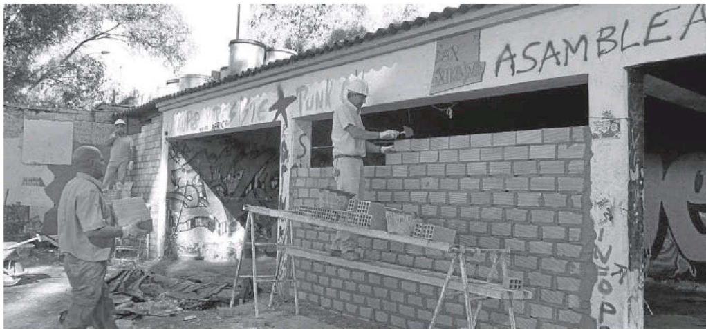
La concesionaria tapió las instalaciones tras la salida forzosa de los ocupantes ilegales. :: SUR. ARCHIVO
