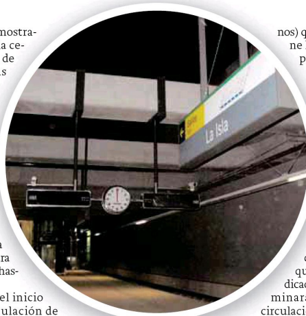
Las estaciones del metro ya están listas. :: SUR
