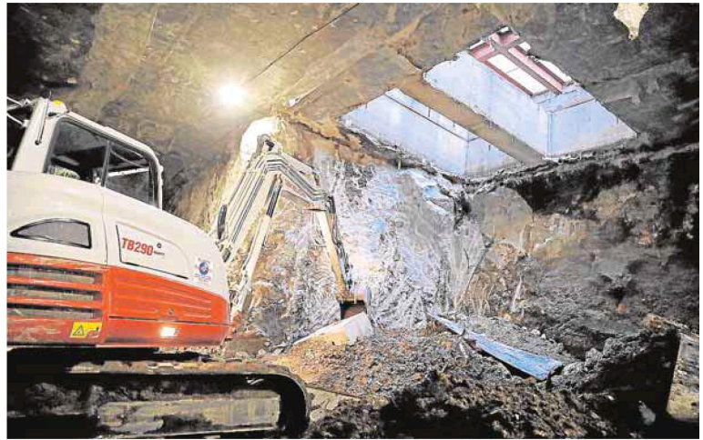
Obras en el interior de los túneles del metro en Callejones del Perchel. :: MIGUE FERNÁNDEZ. ARCHIVO
