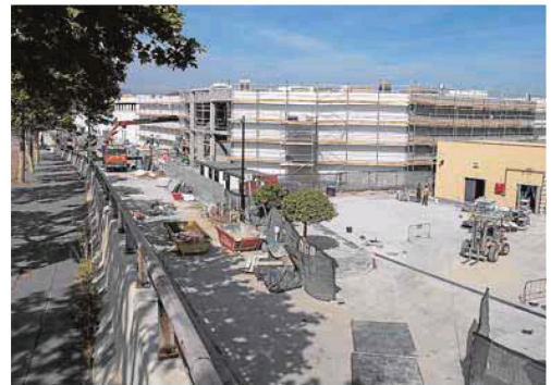
Aspecto de las obras del 'outlet', al este de Plaza Mayor. :: NITO SALAS
