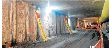
La primera fase del túnel del metro en la Alameda ya se ha excavado. de I. LILLO
