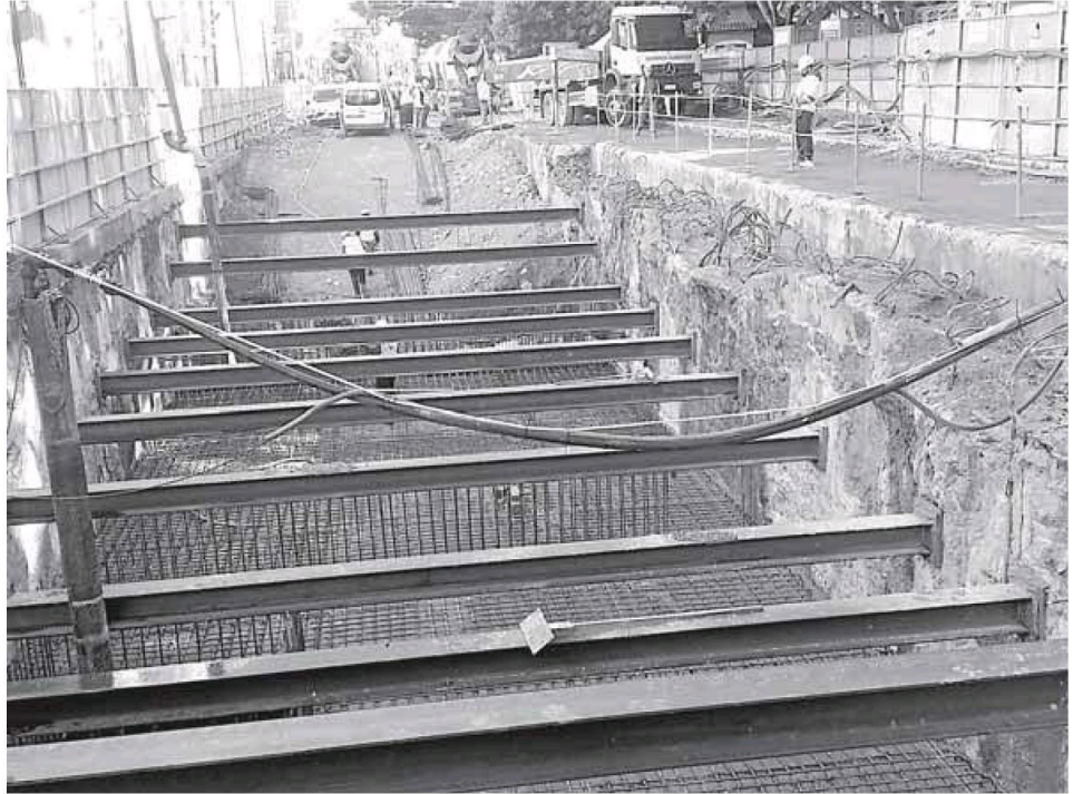
Hormigonado del primer tramo de la losa de cubierta en la Alameda Principal. :: SUR
