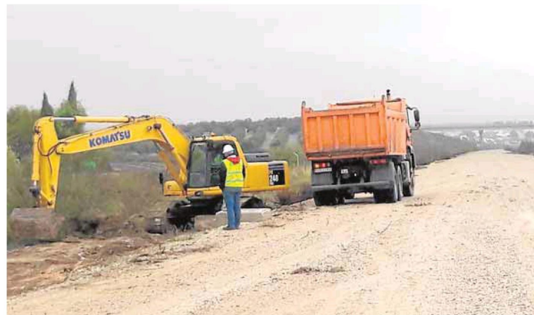
Primeros trabajos de Adif para acondicionar la nueva variante del tren convencional Málaga-Sevilla. :: SUR
