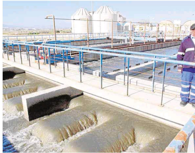
Buena parte de las aguas residuales del Guadalhorce se siguen vertiendo al mar sin depurar. :: SUR
