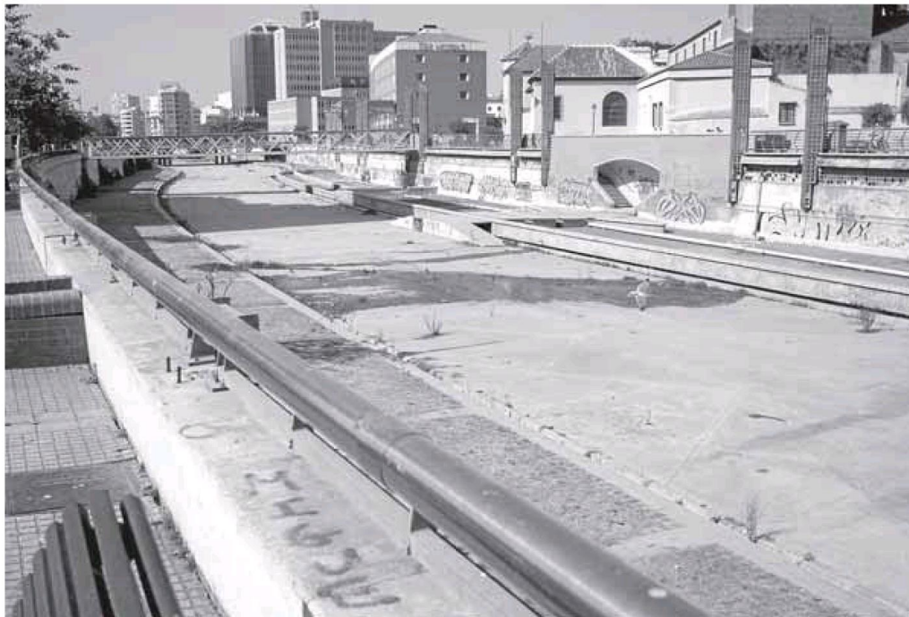
El deterioro es palpable en el tramo del cauce junto a la zona de Santo Domingo. :: ALVARO CABRERA
