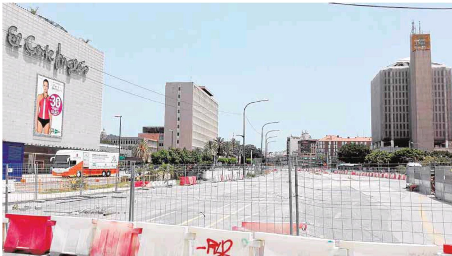
El tajo frente a El Corte Inglés, ya despejado de materiales, espera desde hace más de un año que se retomen las obras. :: MORENO
