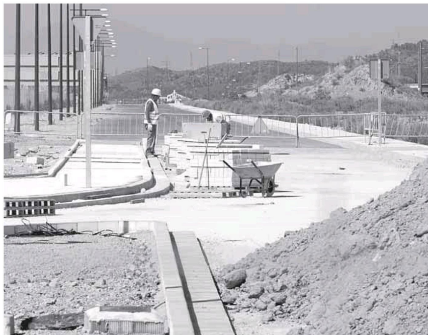
Vial de conexión, en el que se realizan obras para adaptarlo a las exigencias del metro. :: ÁLVARO CABRERA
