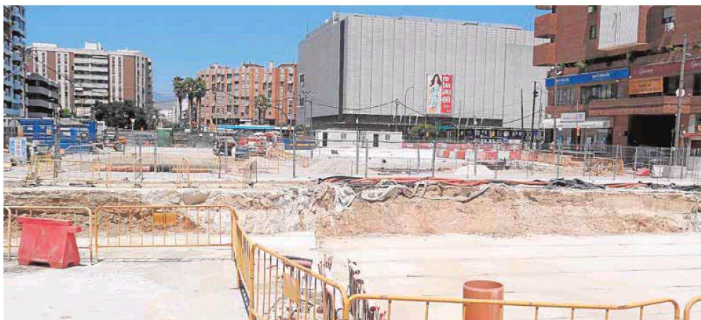
Obras de metro en la glorieta de Albert Camus, que ayer quedaron completamente abandonadas. :: FERNANDO GONZÁLEZ
