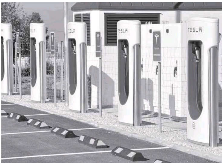
Estación de carga de vehículos Tesla en la Venta del Peral en Cúllar, en Granada. :: JOSÉ UTRERA
