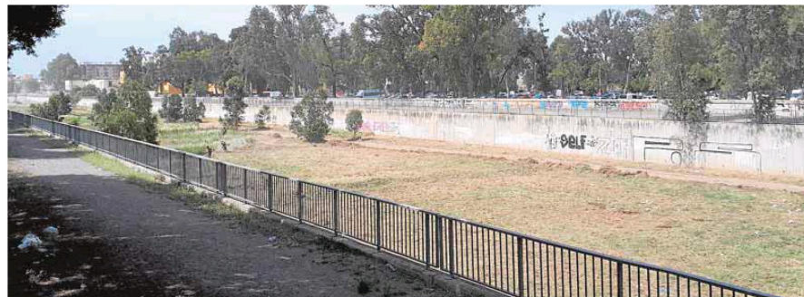
Tramo del cauce situado junto al paseo de Martiricos, en el que ayer continuaron las labores de desbroce a cargo de la Junta. :: SUR
