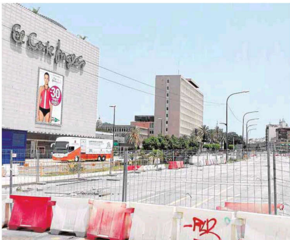
Las obras permanecen paradas en la avenida de Andalucía desde hace más de dos años. :: MORENO
