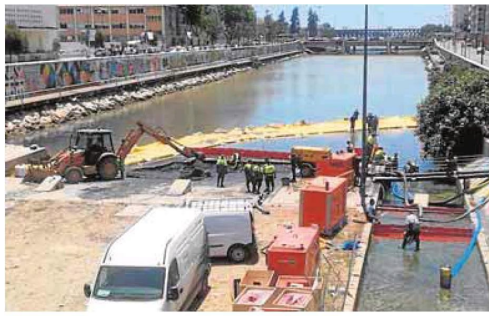
Imagen del operativo desplegado en el cauce del río. :: SUR
