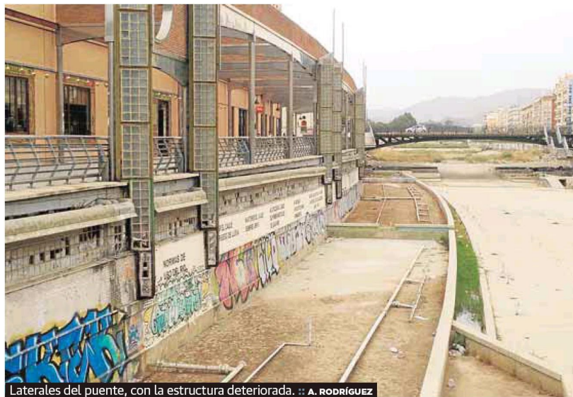
Laterales del puente, con la estructura deteriorada. :: A. RODRÍGUEZ
