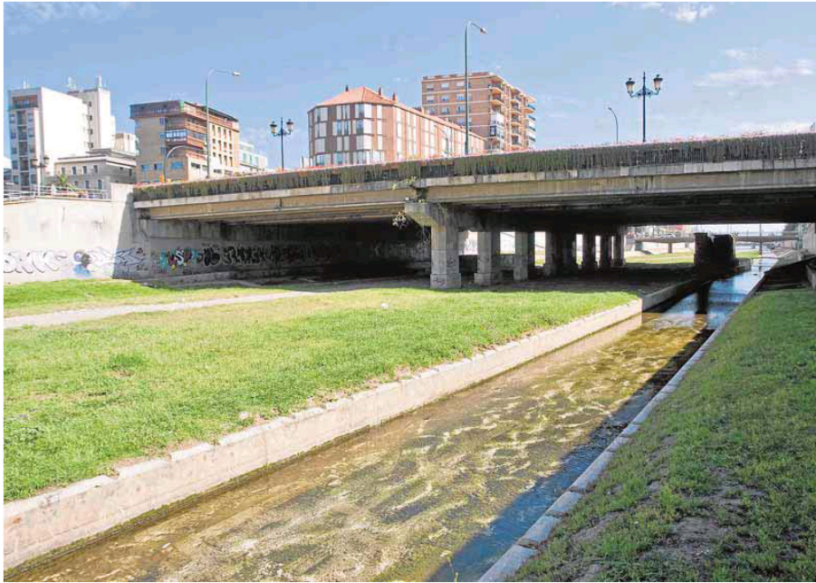
La obra del metro obligará a demoler la mitad norte del tablero del puente de Tetuán. :: ALVARO CABRERA
