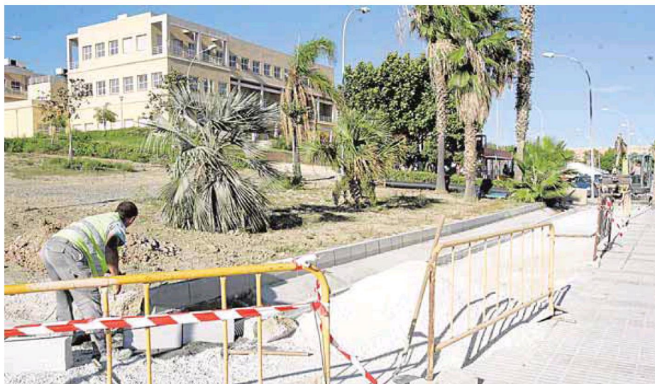
Las obras se están ejecutando en el lateral norte del bulevar Louis Pasteur. :: NURIA FAZ
