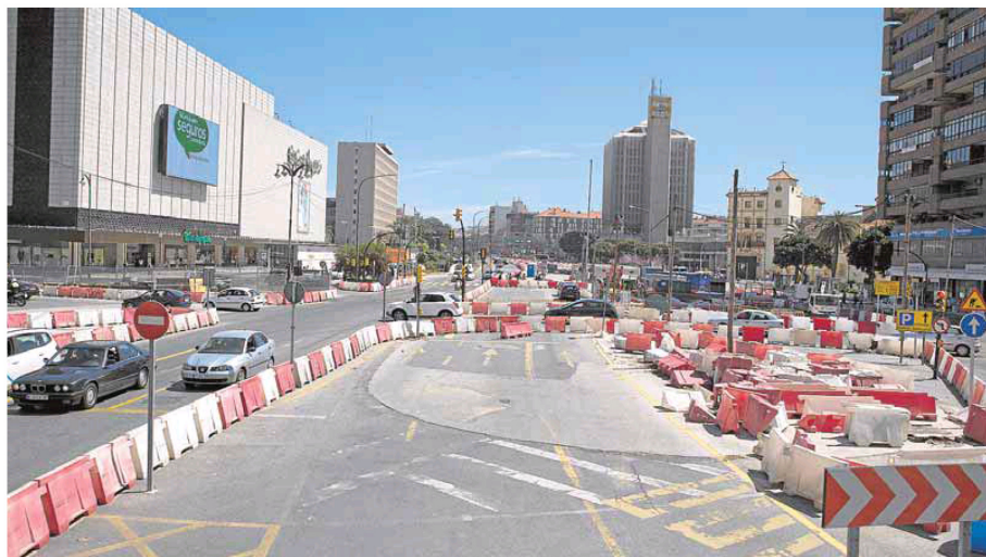
Aspecto de la zona de obras para el futuro túnel del metro en la avenida de Andalucía. :: NITO SALAS
