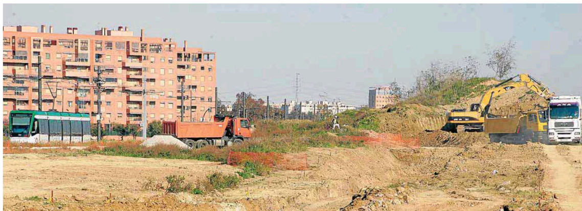
El nuevo vial de interconexión del campus va paralelo a la línea del metro y las obras tienen un plazo de ejecución de cinco meses. :: FERNANDO GONZÁLEZ
